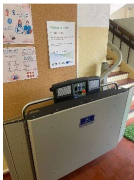
Fig. 172 – Plataforma elevatória instalada na EB Professor Carlos Neto
